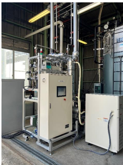
<CO 2 回収装置>
