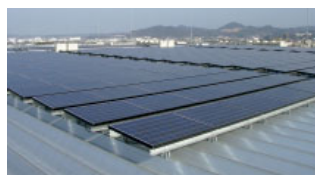
太陽光パネル（小牧工場）
