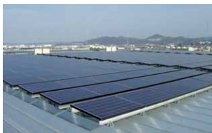
Solar panels (Komaki Plant)
