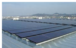
太陽光パネル(小牧工場)
