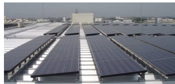
太陽光パネル(第14工場屋上) 約640枚の太陽光パネルが並ぶ
