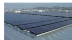
Solar panels (Komaki Plant)
