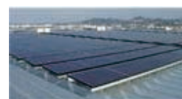
太陽光パネル(小牧工場)
