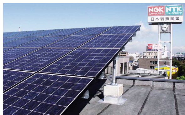
太陽光パネル
