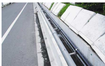
宮之城：地上配管
