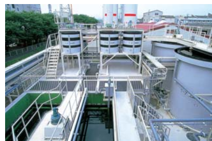
小牧工場 排水処理施設
