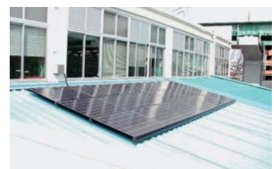
太陽光発電設備
