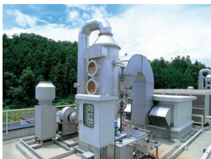
排気ガス処理装置
