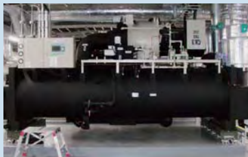
ターボ冷凍機
