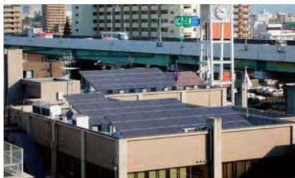
太陽光発電設備
