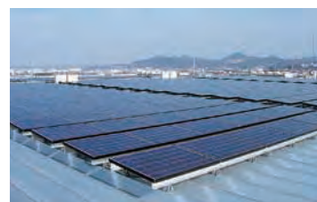
太陽光パネル
