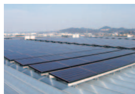
太陽光パネル
